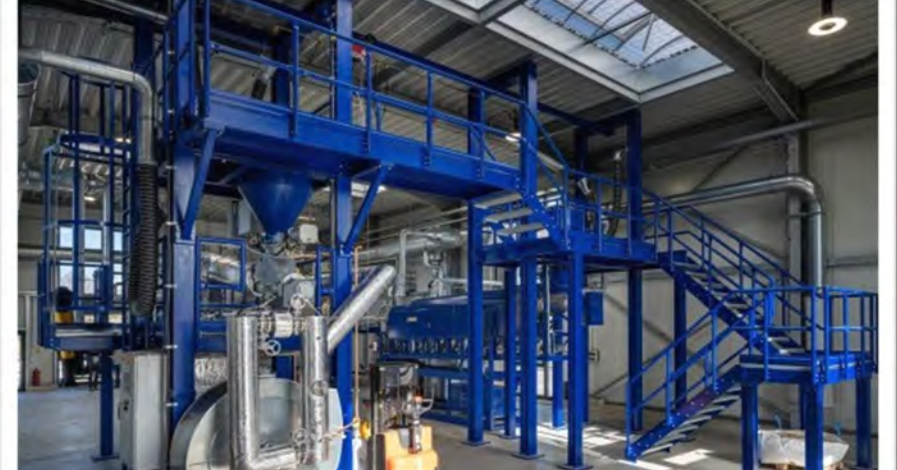
Thermochemische Anlagen (Verbrennung, Pyrolyse, Vergasung, HTC)
