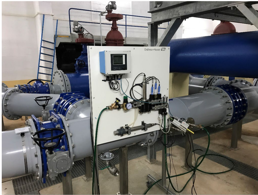
Messpanel an Hochbehälter 2
