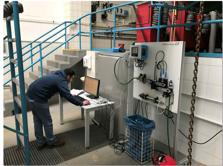
Messpanel an Hochbehälter 3
